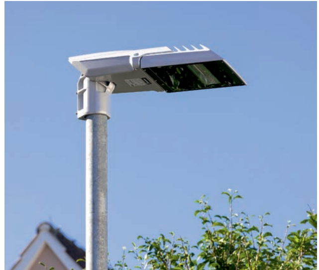
Die Masten mussten in Unterensingen nicht verlängert werden (Beispielbild)
